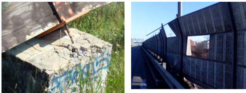
Рис. 4 – поврежденные шумозащитные экраны
